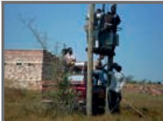
Eindelijk is het zover: een nieuwe transformator.
